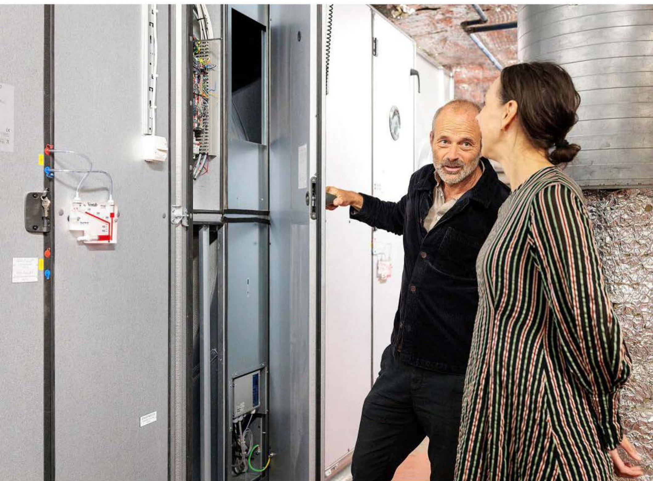
Mikael Hilmart och Åsa Lindell vid de nya ventilationsaggregateten i fläktrummet på takvåningen i det ombyggda huset.
